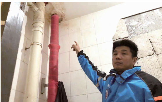
王志强发现管道漏水
